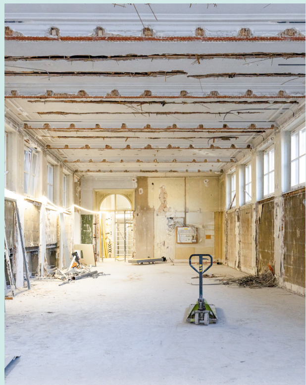
Rückbauarbeiten im Gebäude der Alten Gewerbeschule, hier im künftigen Lesesaal der neuen Bibliothek.
